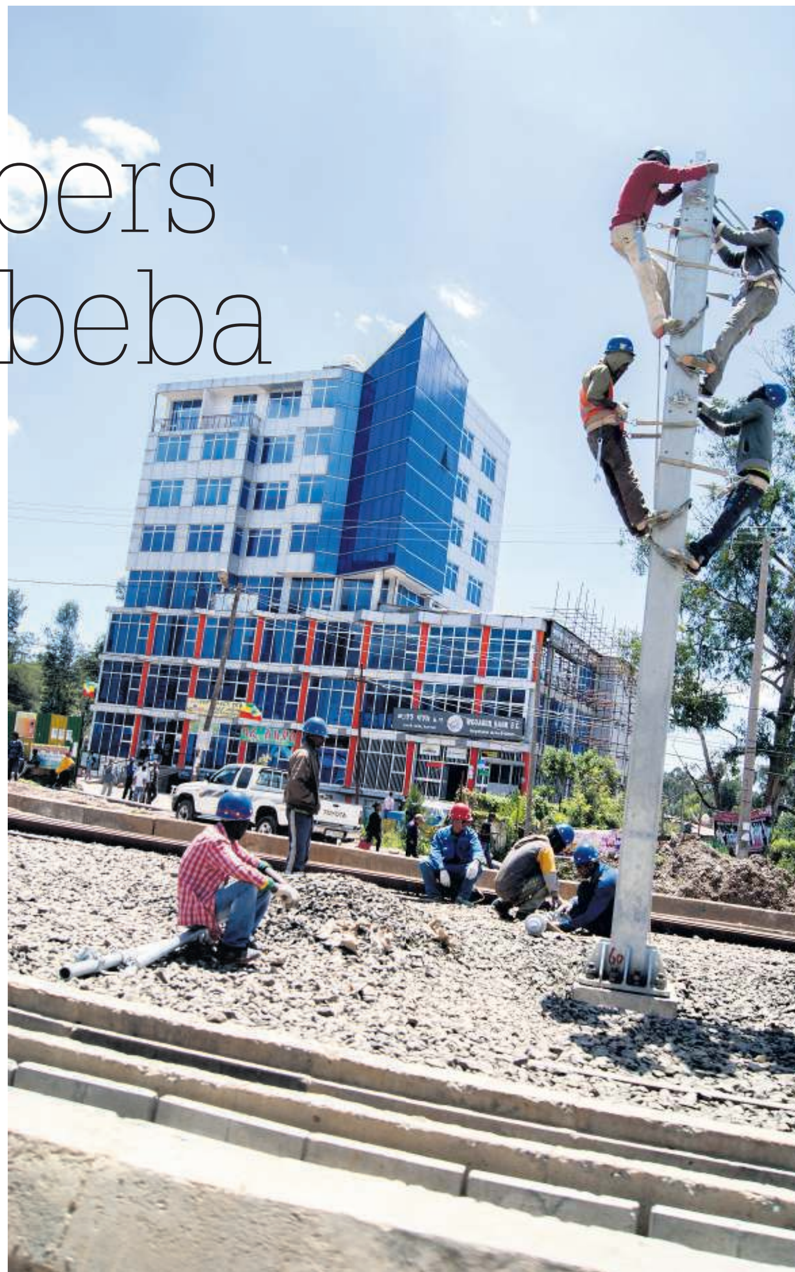
In de Ethiopische hoofdstad Addis Abeba bepalen moderne kantoorgebouwen de skyline. Chinese aannemers leggen een tramlijn aan.
